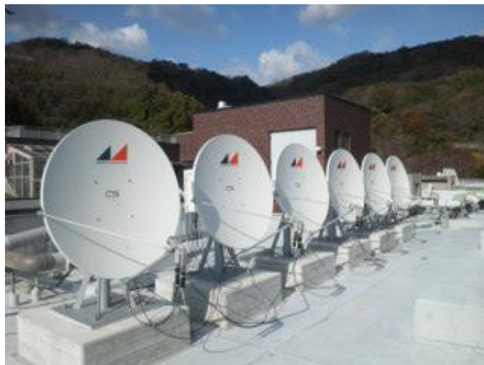
図 4.1 甲南大学の屋上に設置している 12 台の BS アンテナ
