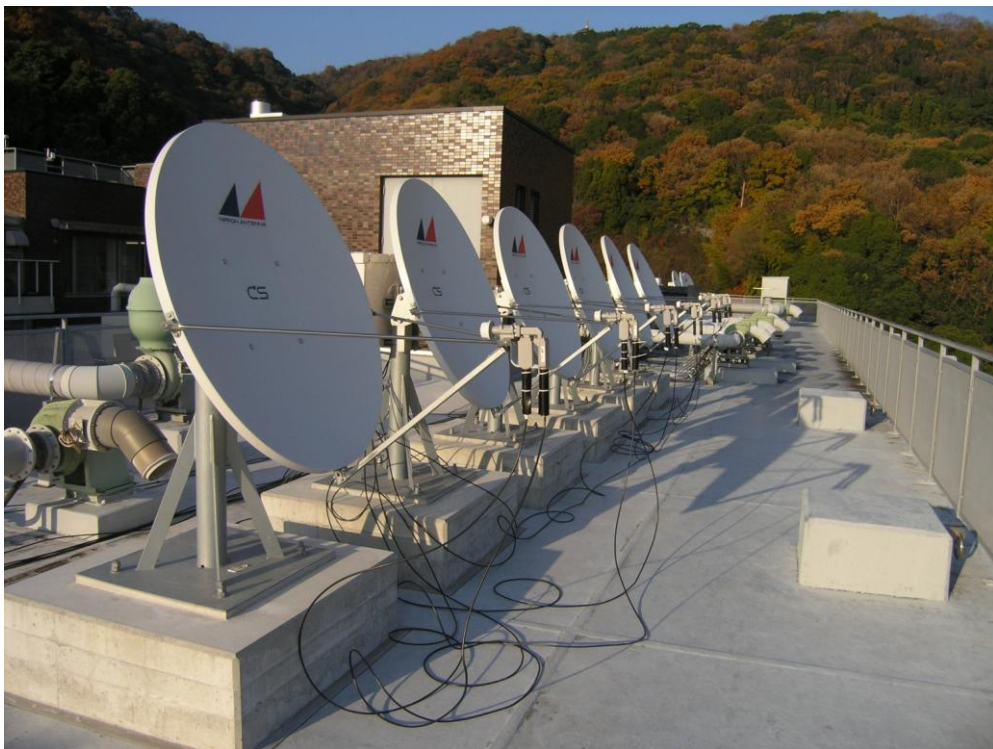
甲南大学17号館屋 12台のアンテナの電波アンテナ
