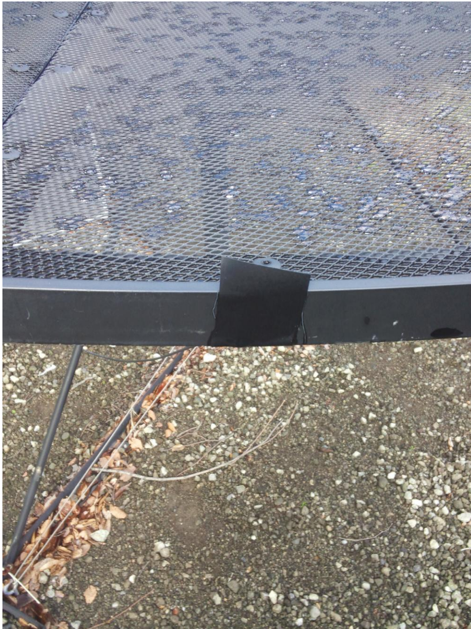
アンテナの底部の張ってあるテープ
